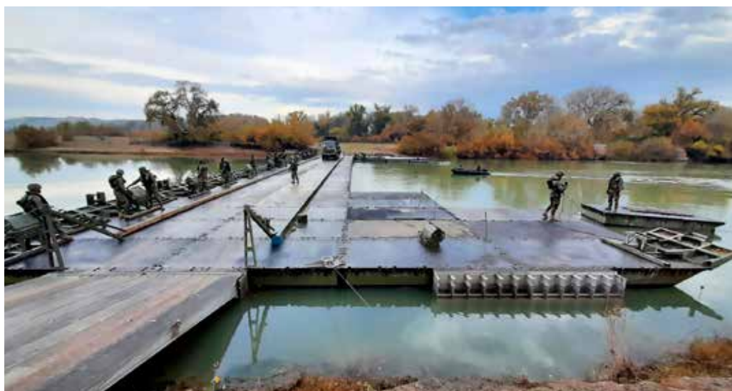
El Regimiento de Pontoneros y Especialidades de Ingenieros Nº 12 (RPEI 12) demuestra la versatilidad del Ejército. Foto: DECET
